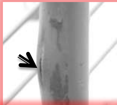
تخریب لوله در اثر انبساط آب درون لوله
